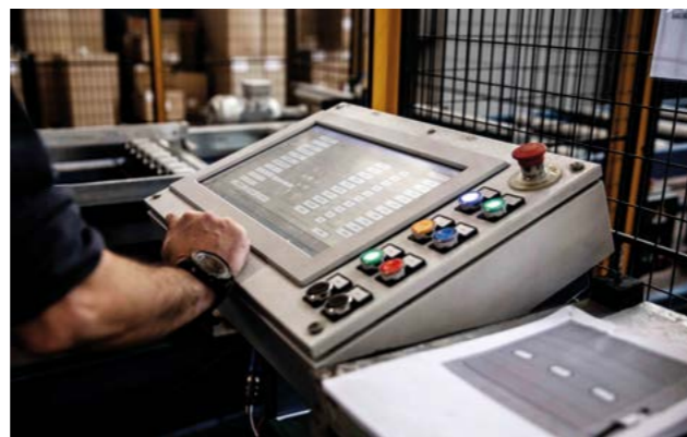
Sistema di controllo automatizzato. Automated control system.
